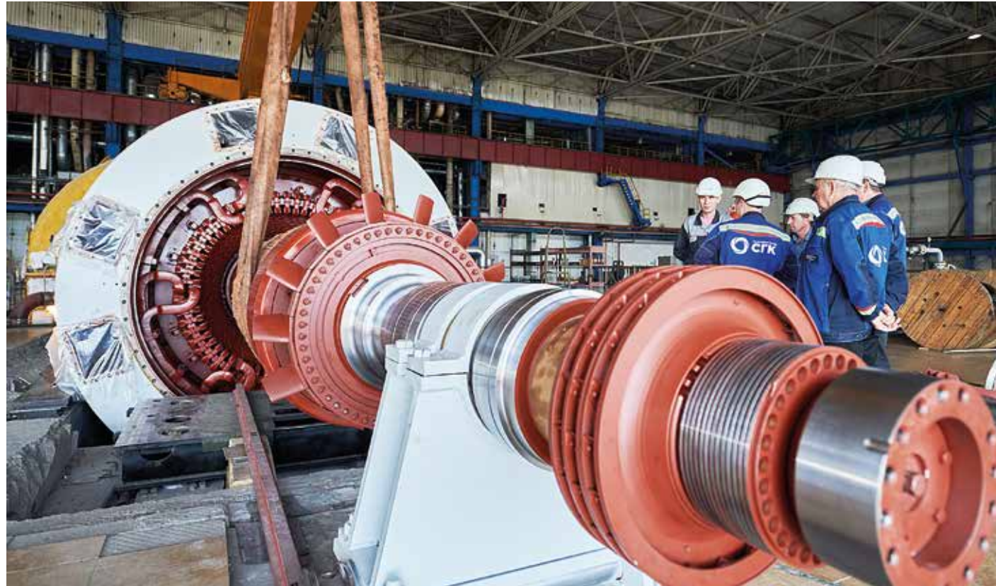
В 2018 году на Красноярской ТЭЦ-3 заработал новый генератор. Его сборка — ювелирная работа, при установке ротор не должен касаться обмотки статора
